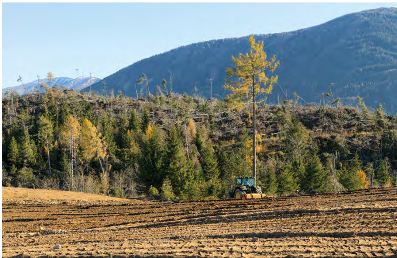
FOTO 7.15 - Lavorazione con fresa di tipo stradale per l'affinamento del letto di semina
