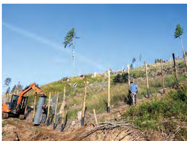
FOTO 7.10 - Realizzazione di una recinzione di protezione delle piantine nella foresta demaniale di Paneveggio
