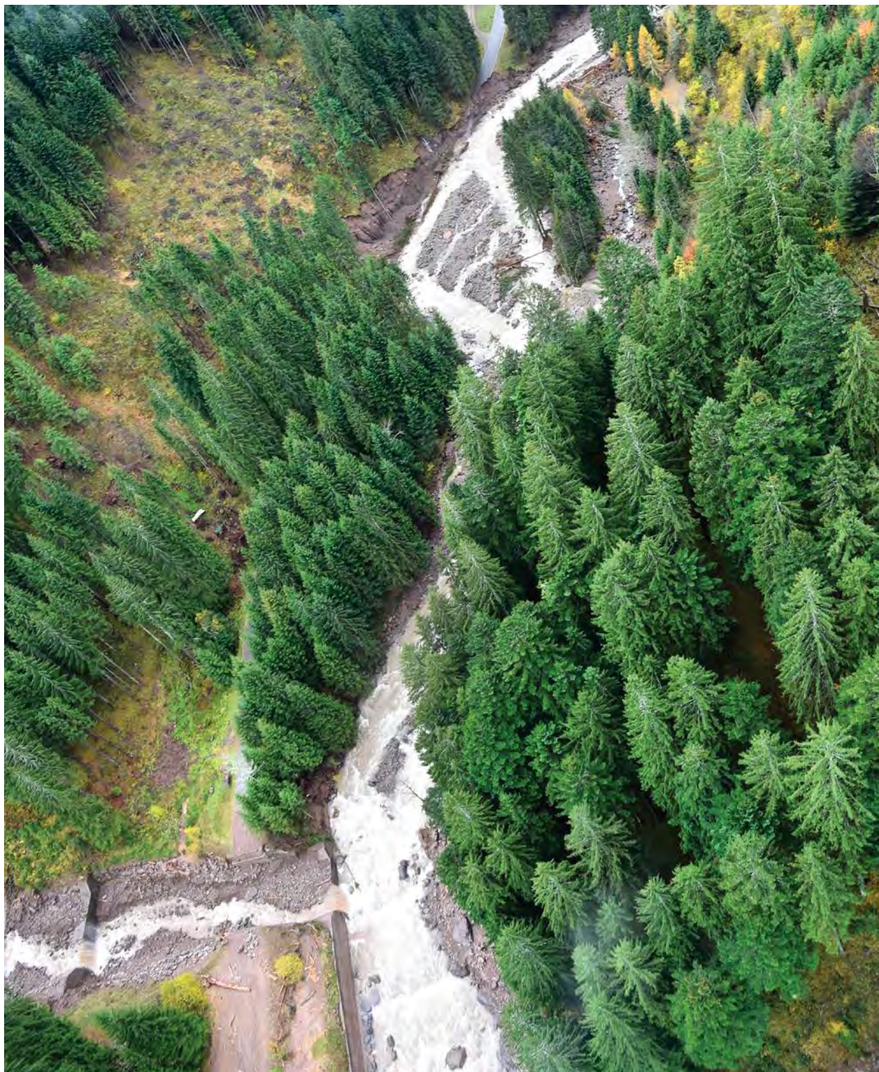
FOTO 1.2 - Cedimenti diffusi lungo la Strada provinciale n. 31 causati dall'erosione del Rio Cadino e dei suoi affluenti secondari
